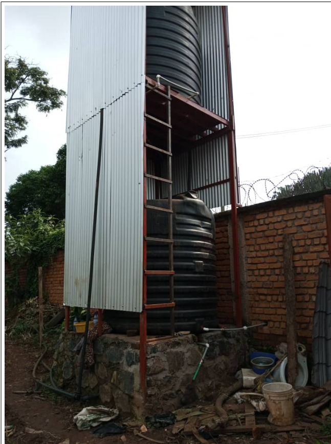
Wasserturm mit Filterung und Desinfektion
